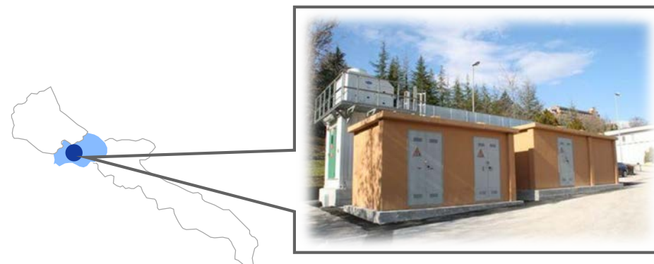
Cabina Primaria Carpinone (IS) (1 MVA – 0,5 MWh)
