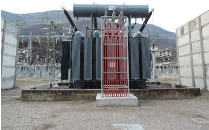
Trasformatore 50 MVA 230 kV
