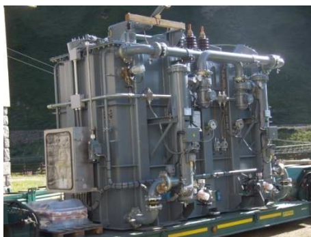
Trasformatore 26 MVA Step-up
