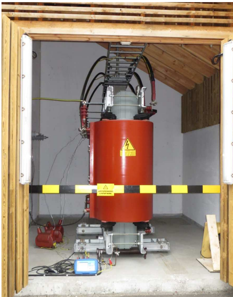
Misure effettuate nell'impianto
