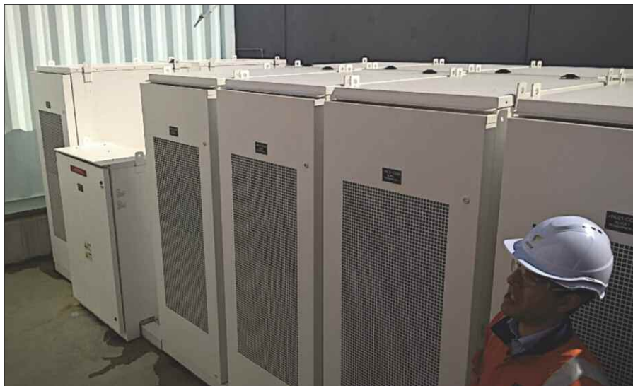
Foto Particolare del complesso storage Tesla.
