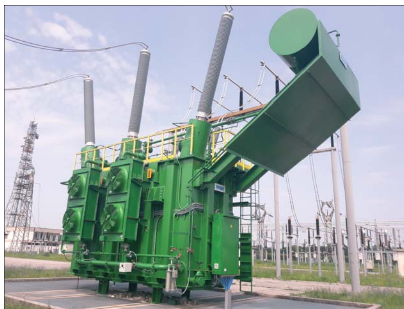
Figura 1 Il primo autotrasformatore "verde" d'Italia, realizzato da Tamini e installato da Terna
